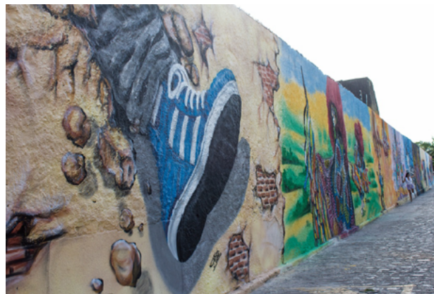
Figura 3: Rua Barbosa Lima, n. 81. Conjunto tombado do Bairro do Recife, após a intervenção (9/9/2018). Detalhe com aproximação
